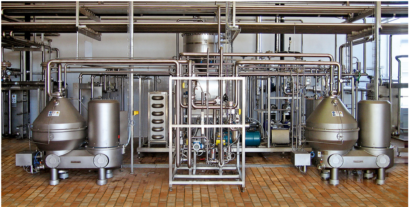
Doppio impianto di pastorizzazione.
